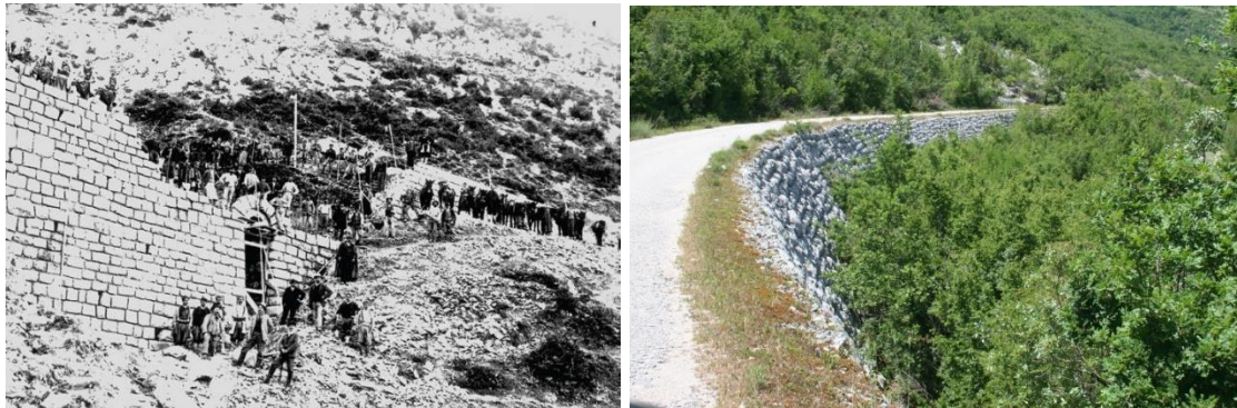
Slike 24.-25. Izgradnja pruge Gabela - Zelenika kod Sutorine (lijevo); Podzid željezničke pruge kraj Dikličića (desno) 14
