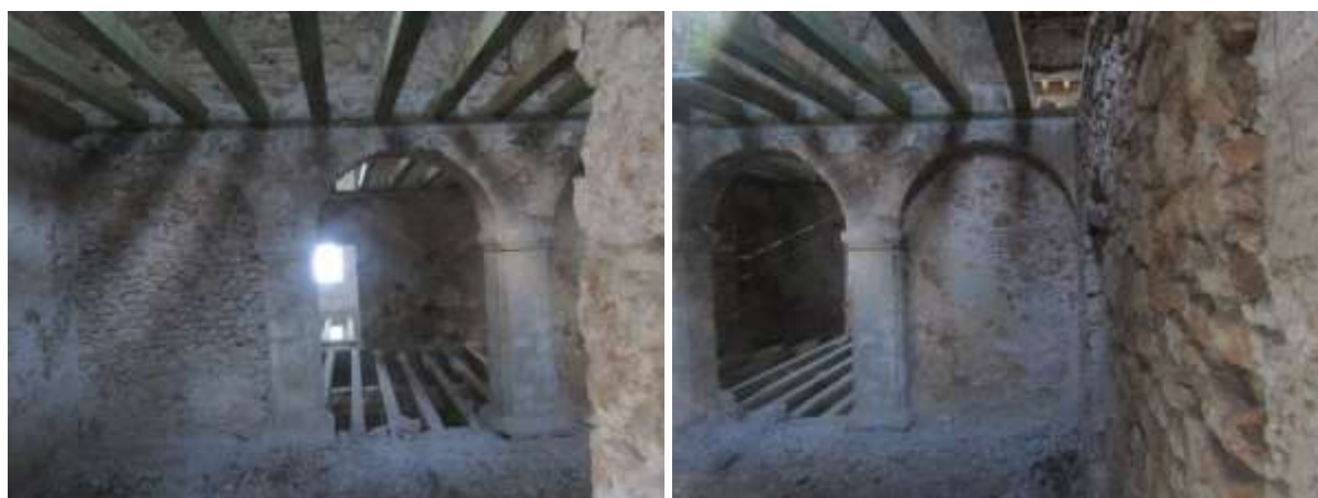
Slike 21.-22. Pogled kroz prozore na (sjevero)zapadnoj strani objekta u pravcu istoka u razini prizemlja zapadne strane, odnosno prvog kata istočne strane (foto: Krešimir Šaravanja)
