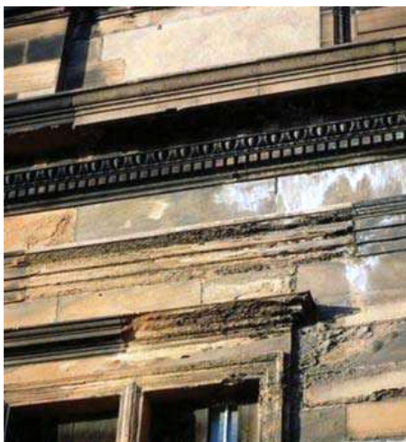
Slika 4: Degradacija zida od crvenog pješčara zbog oštećenja oluka za odvod kišnice iza parapeta
