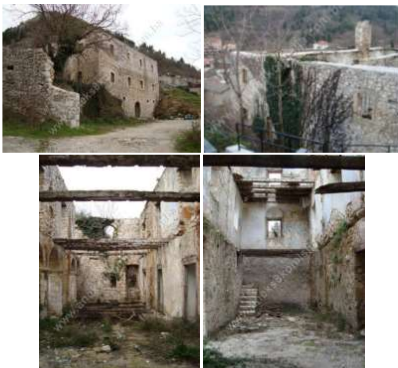
Slike 36.-39. Biskupska rezidencija na Vukodolu 2009. godine ( www.kons.gov.ba ): Ulazni dio s jugoistočne strane (gore, lijevo); pogled s sjeverozapadne strane (gore, desno) Fotografije unutrašnjosti kompleksa (dolje, lijevo i desno)
