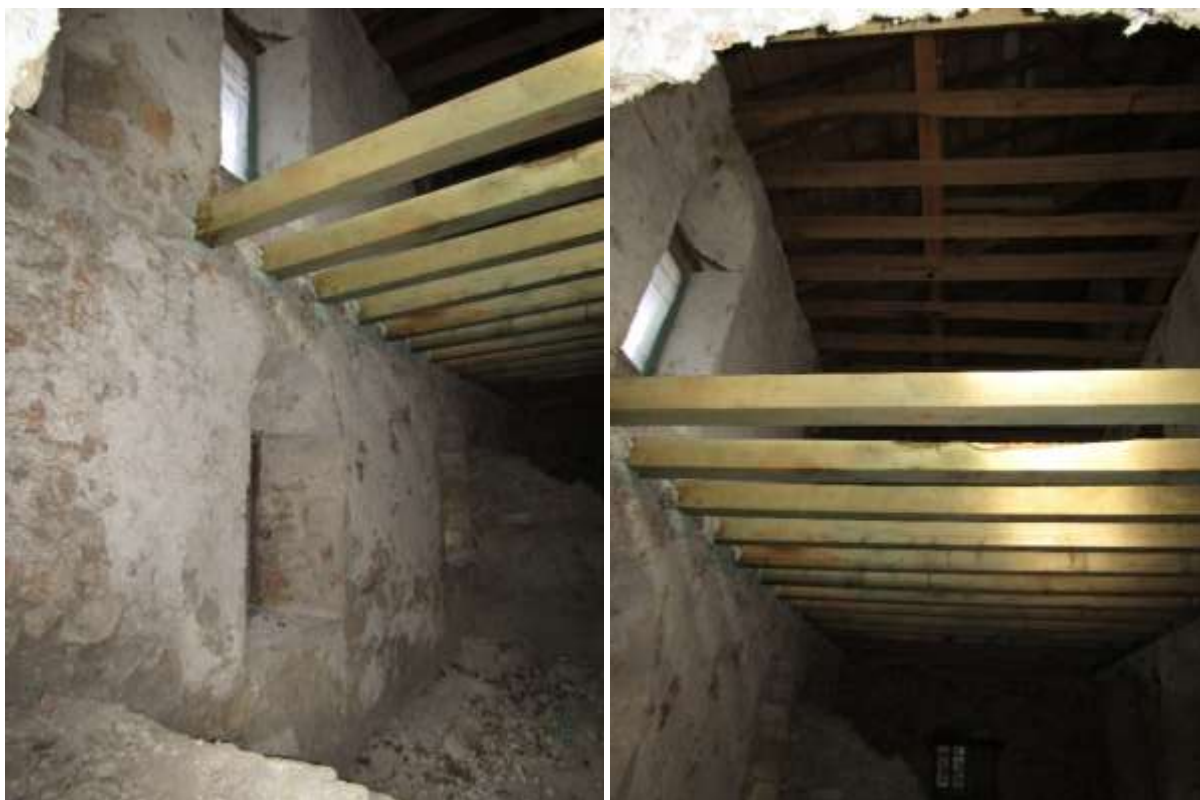
Slike 19.-20. Pogled na ulazno stubište na jugozapadnom kutu objekta (lijevo), s pogledom prema krovnoj konstrukciji (desno); slikano kroz prozor označen na Slici 13 u pravcu sjevera (foto: Krešimir Šaravanja)
