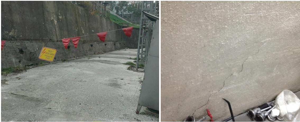
Slika 2. Fotografije nastalih oštećenja izdizanje platoa između zida i objekta (lijevo); pukotina na zidu unutar objekta (desno) 3
