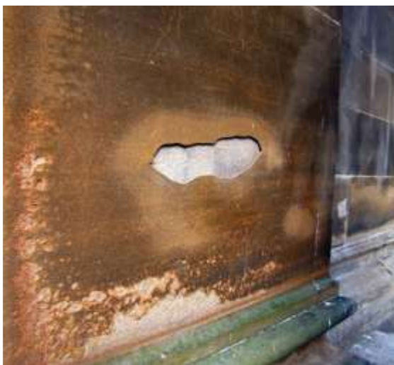
Slika 7: Stvaranje mjehura na zidu od pješčara uzrokovano širenjem sloja površine zbog utjecaja vremena što vodi ka gubitku kamene površine
