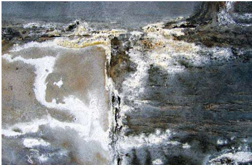
Slika 17: Formiranje soli stvarajući cvjetanje na površini zida od pješčara što se spaja u pukotinama između blokova zida
